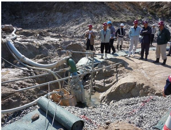
【ポンプによる汲み上げを説明】
